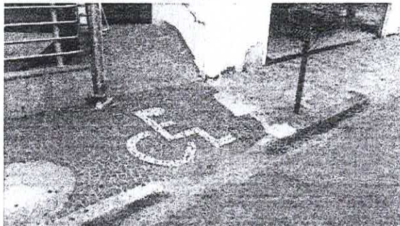
Fotografia 22. Rebaixamento de calçada de vizinho do nº 2745
