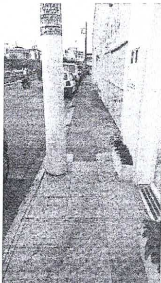
Fotografia 60. Calçada, altura do nº 2346
