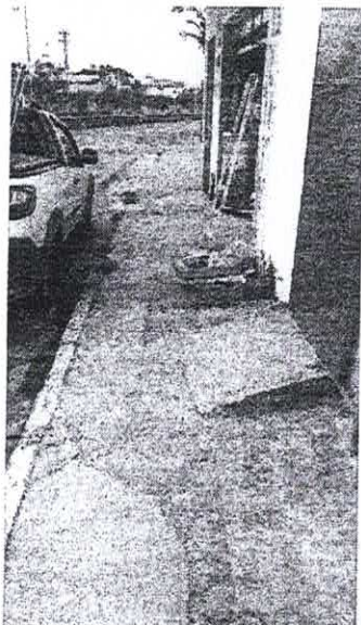
Fotografia 12. Calçada, altura do nº 2985
