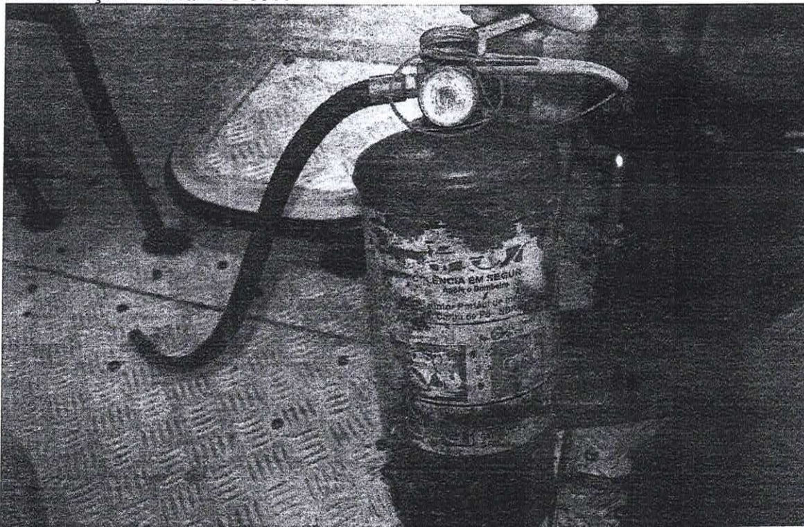
Fotografia 92. Extintor de incêndio descarregado e em péssimo estado de conservação - Placa DVS 8511
