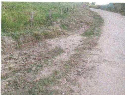
Foto: erosão na estrada
