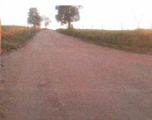
Foto: estrada sem pavimentação asfáltica
