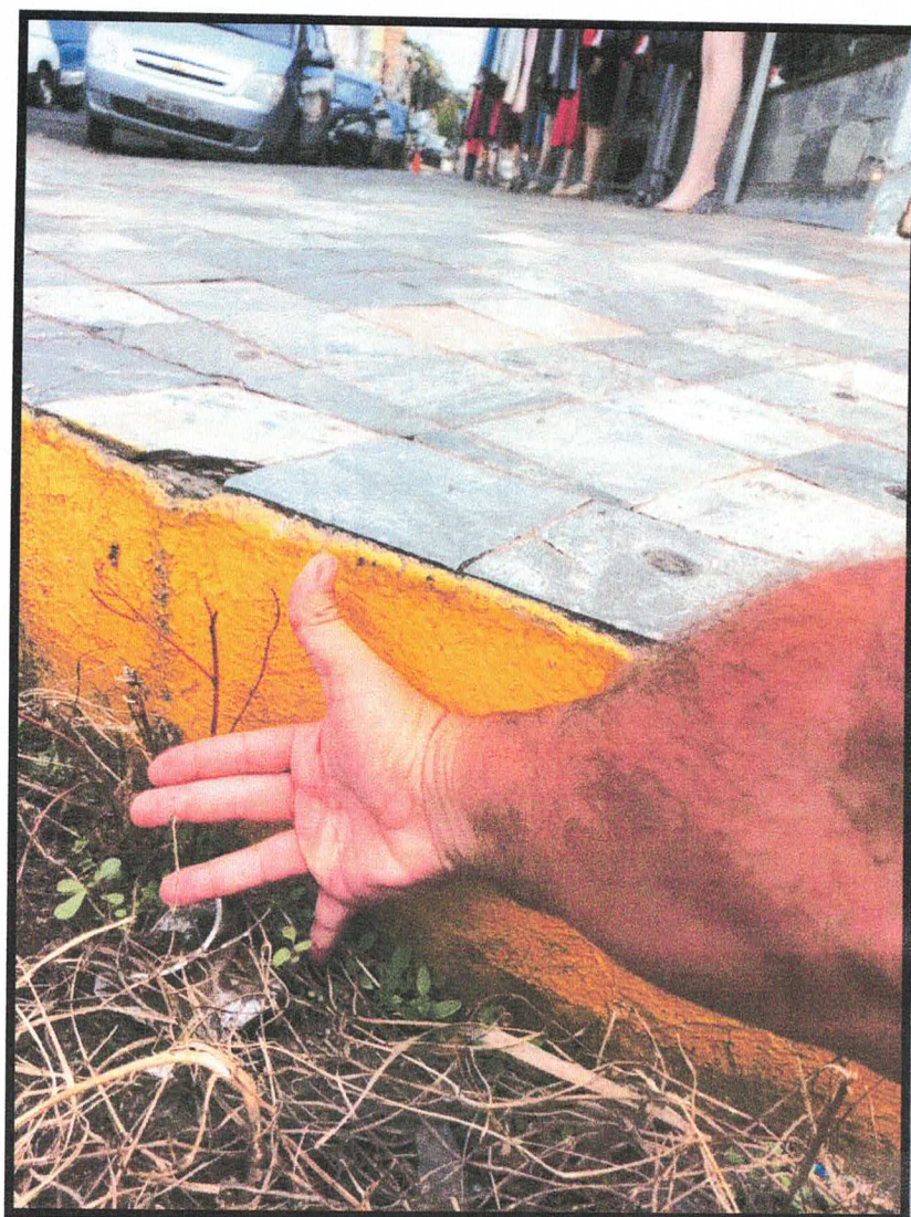
Anexo 1: Amplitude de desnível entre rua e calçada.
