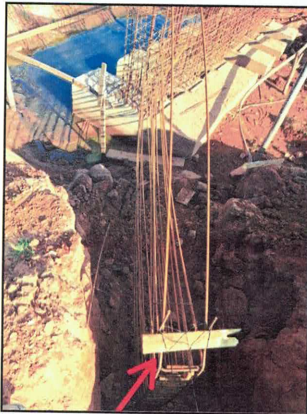
Imagem: Estrutura de sustentação aparentemente superficial, sem uma base sólida abaixo do solo.
