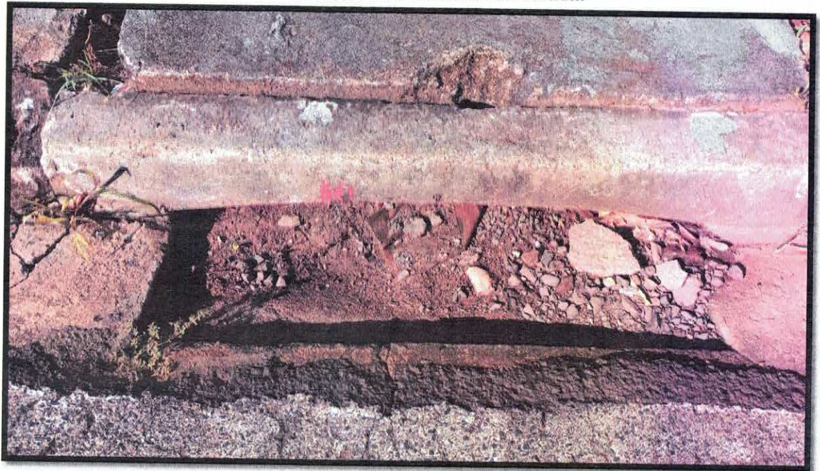
Anexo: Imagens dos bueiros entupidos e sem proteção localizados nos finais das ruas Luiz Spinelli e Natal Cominato, no bairro Jardim Alvorada.
